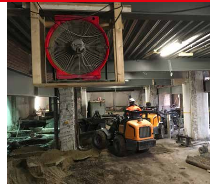
Ventilatoren verbeteren de luchtkwaliteit.
