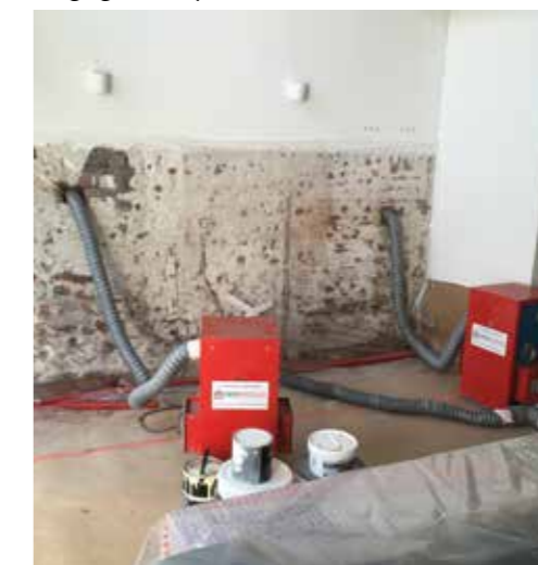
Droging in een spouwmuur.
