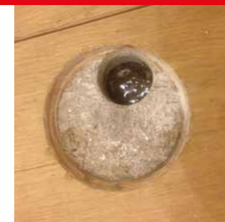
Voorbeelden van vocht tussen de isolatielaag.
